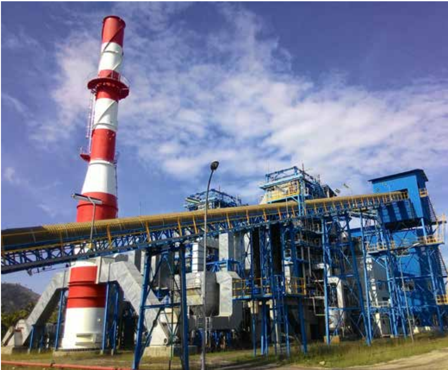
▲ PLTU Ropa (2 X 7 MW) TPP Ropa (2 X 7 MW)
